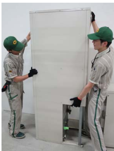
エネファームの設置
